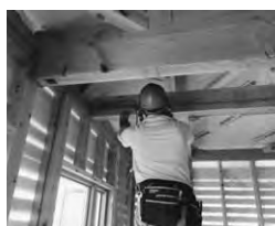
室内配線：報国電設
