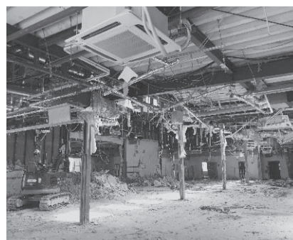
室内被害状況
