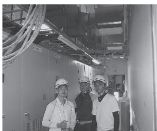
屋内配線：木多電気設備
